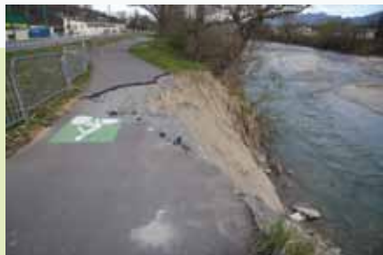
Dégradation naturelle d'un aménagement irréfléchi de voie "verte", à Crest (26).
